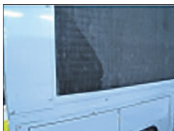
室外機の油にじみ
