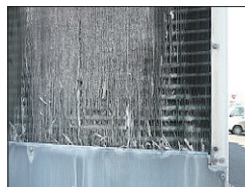
室外機の腐食
